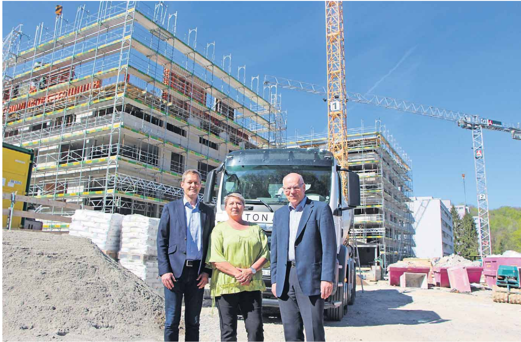
Vor der Grossbaustelle im Alterszentrum Kehl (v. l.): Martin Haefeli, Leiter Finanzen, Daniela Oehrli, VR-Präsidentin, und Ueli Kohler, Geschäftsführer.
